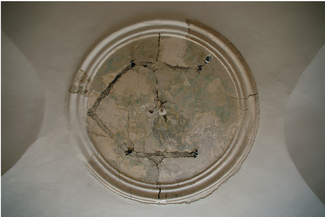
Stav v průběhu odkryvu, odhalení množství hloubkových defektů. Okraj profilace je níže než okolní vrstva novodobého štuky, která pokrývá strop i stěny.
