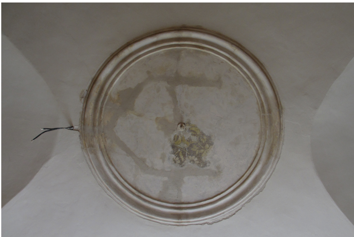
Stav po vytmelení.
